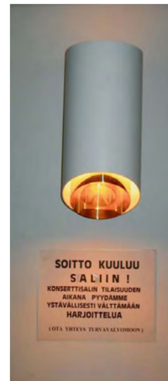
Käytävän seinävalaisin V31. Kuva Pirjo Hyytiäinen
